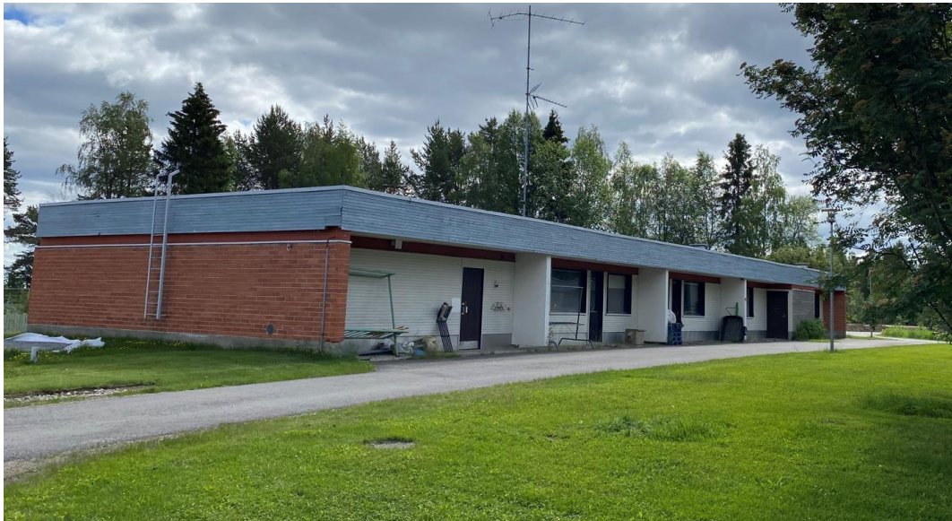
Kuva 5 Pääskylänniemen rivitalot ovat kärsineet tulvavahingoista.
