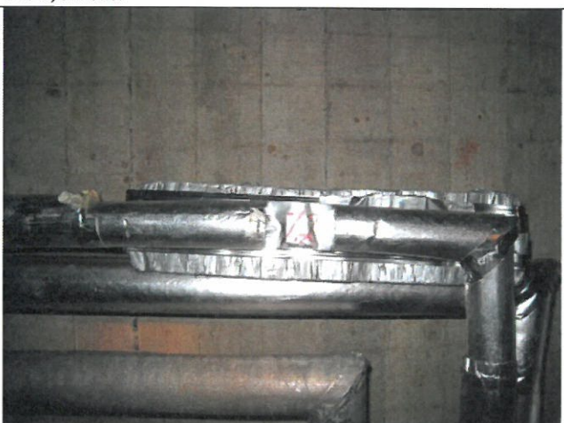
Kuva 12. RTG12, Lvk-runkohaara 15/1,0 mm (uusittua kupariputkea!).
