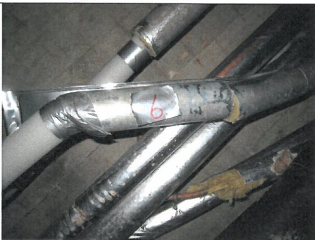
Kuva 6. RTG6, Kv-runkohaara 22/1,0 mm (uusittua kupariputkea!).
