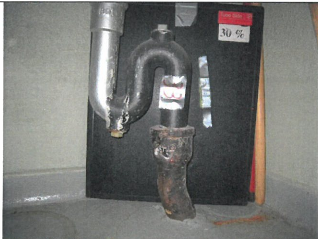
Kuva 33. RTG33, Kaatoaltaan valurautainen vesi-lukko-osa 55/4,0 mm ja kytkentähaaran pystyputkiosa 60/5,0 mm.
