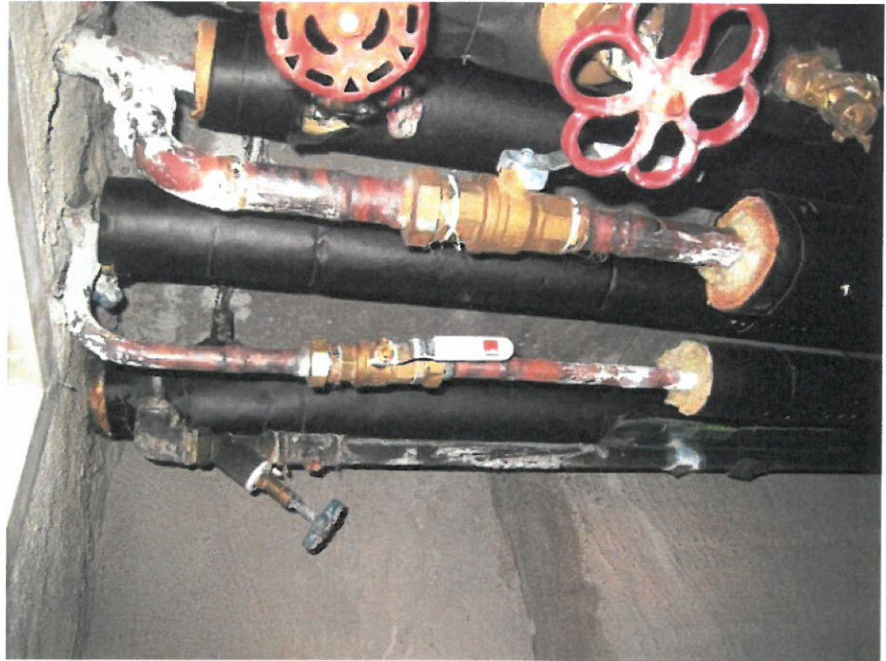
Kuva 1. Kohderakennuksen kylmän käyttövesiverkoston sinkityllä teräsputkella putkitetuilla osuksilla sulkuventtiilit ovat yleensä alkuperäisiä vinokarasulkuja. Lv- ja lvk-runkohaaroissa sulkuventtiilit ovat tyypillisesti jossakin vaiheessa uusittuja pallosulkuja.
