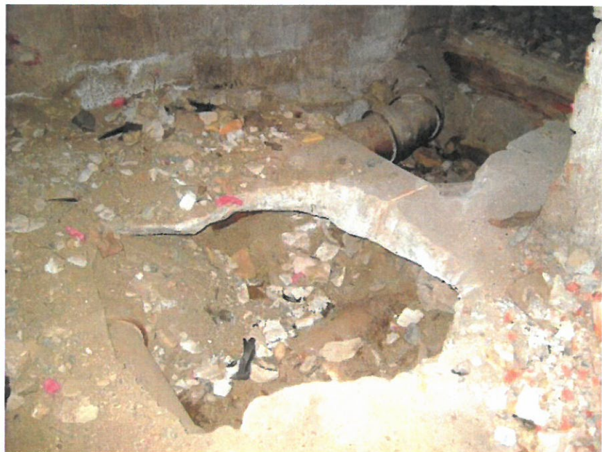
Kuva 6. Koulurakennuksen kellarikerroksen putkikanaalien betonisen lattia-rakenteen alapuolella kulkevat valurautaviemärin putkiosilla putkitettuina ilmeisesti sekä jätevesiverkoston että sadevesiverkostonkin pohjaviemäriin. Valurautaviemäriosien väliset liitokset on tehty muhviliitoksina.
