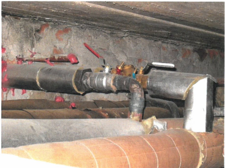
Kuva 12. Koulurakennuksen kellarikerroksen putkikanaaleissa osa lämmitysverkoston runkohaarojen sulku- ja säätöventtiileistä on uusittu malliltaan pallosuluiksi. Paluupuolen uusituissa säätöventtiileissä on varusteena linjahaarakohtaisten vesivirtaamien mittaussyhteet.
