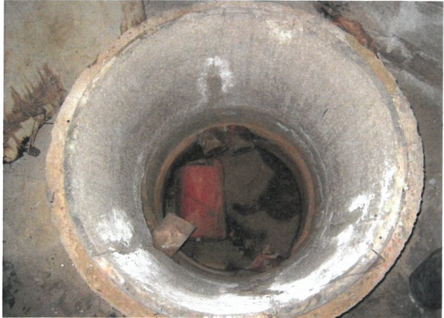
Kuva 9. Majarin kellarikerroksen putkikanaalissa on betonirenkailla toteutettu salaojaverkoston tarkastuskaivo. Kaivon pohja oli katselmushetkellä kuivana. Kaivon pohja on noin 800 mm:n etäisyydellä putkikanaalin lattian pinnasta alaspäin. Kaivolle näkyvät salaojien tiilipukitukset.
