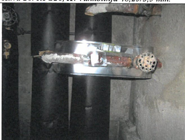
Kuva 28. RTG28, Lj-runkohaara, menoputki 33,7/3,25 mm.
