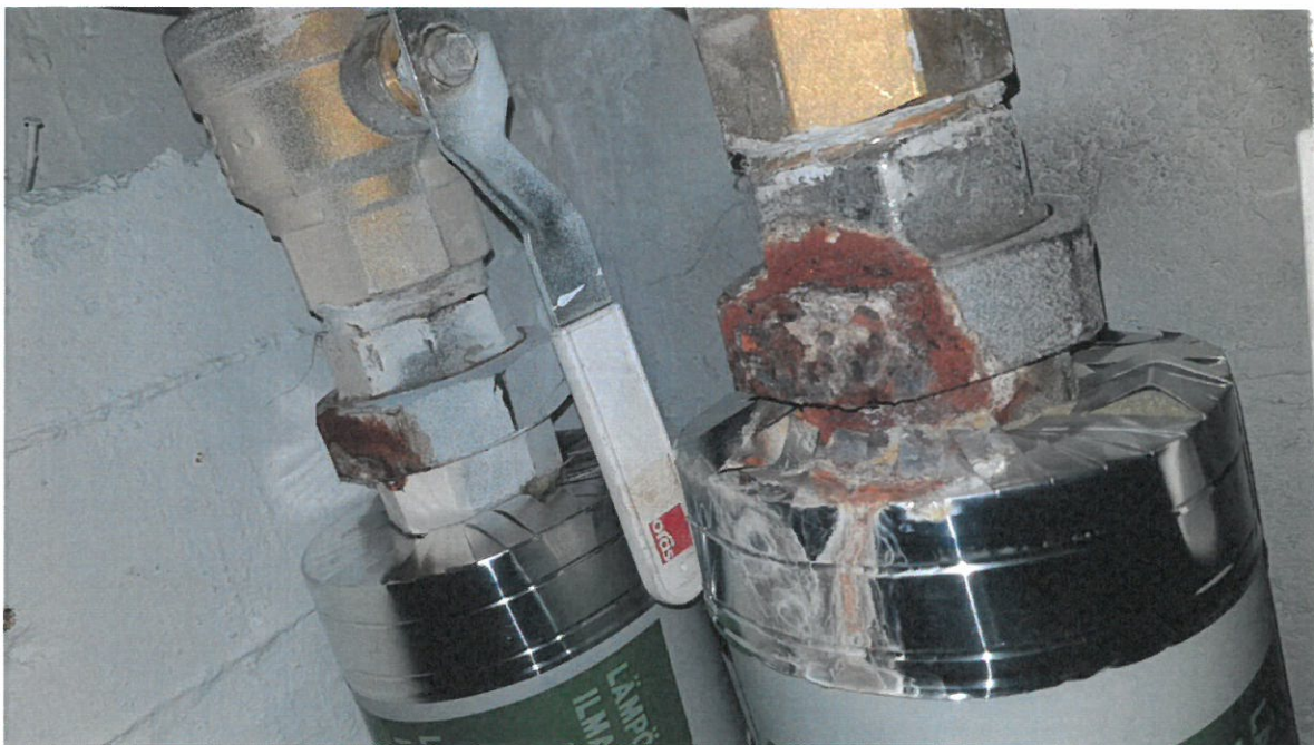
Kuva 7. Korroosiota venttiilien liittimissä
