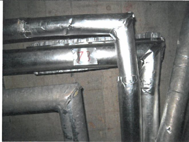
Kuva 13. RTG13, Lv-runkohaara 28/1,2 mm (ilmeisesti vanhaa kupariputkea, vaikka eristepaketti on uusittua mallia!).
