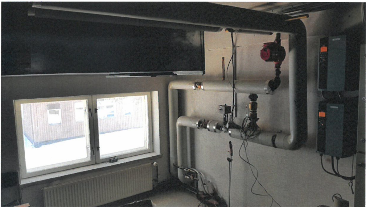
Kuva 13. Liikuntasaliosan IV-konehuoneen lämpöjohdot
