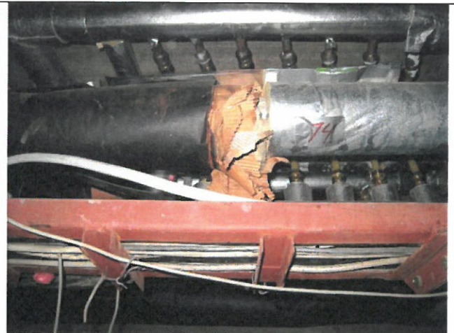
Kuva 14. RTG14, Kv-runkolinja 60/3,75 mm.
