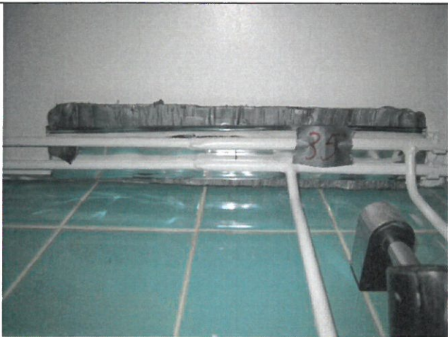
Kuva 35. RTG35, Kv- ja lv-kytkentähaarat 15/1,0 mm (uusittua kupariputkea!).
