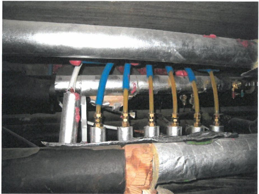
Kuva 5. Koulurakennuksen kellarikerroksen putkikanaalista kohti ruokalattian valmistuskeittiötä lähtevät kv- ja lv-verkostojen kytkentähaarat ovat asennettuina muovisten suojaputkien sisälle sujutetuilla muovisilla virtausputkilla.
