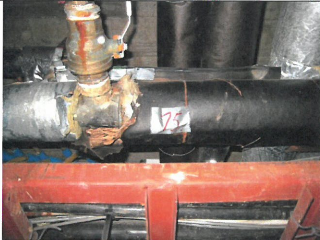
Kuva 15. RTG15, Kv-runkolinja 60/3,75 mm.
