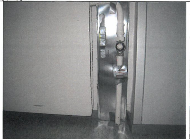
Kuva 40. RTG40, Patterin kytkentähaara, menoputki 21,3/3,25 mm.
