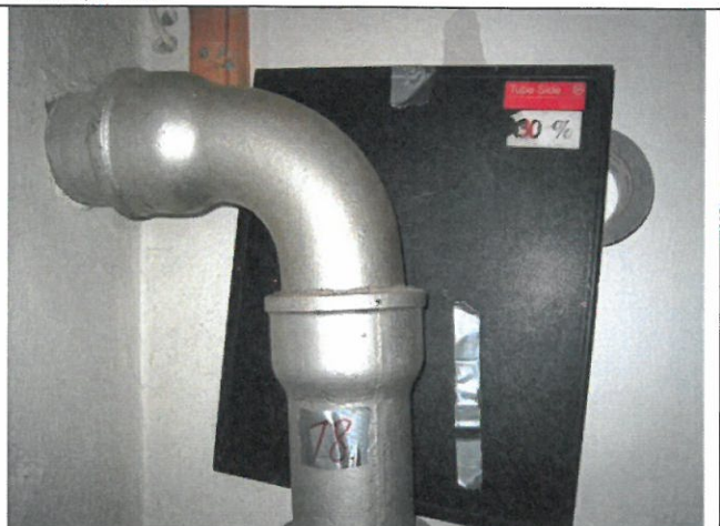
Kuva 18. RTG18, Pystyviemärilinjan putkiosat 112/6,0 mm.
