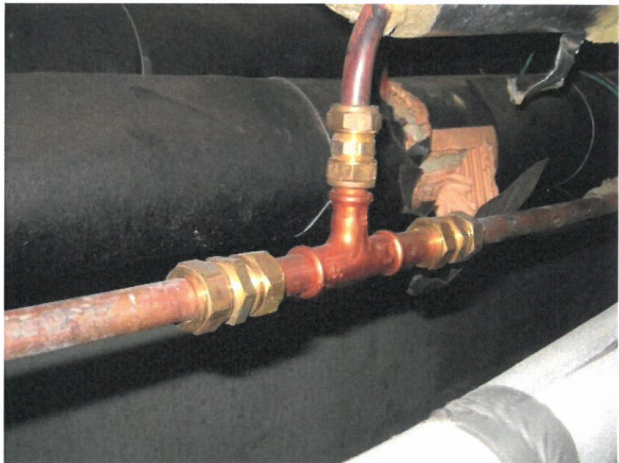
Kuva 4. Koulurakennuksen kellarikerroksen putkikanaalissa (lähellä pohjakerroksen kotitalousluokan 10 ovea!) lvk-verkoston vanhan kupariputkiosuuden yhtä T-haaroituksen kohtaa on paikallisesti korjattu mm. kuparisilla puristusliitososilla ilmeisesti toteutetun vuotokohdan korjaustyön yhteydessä.
