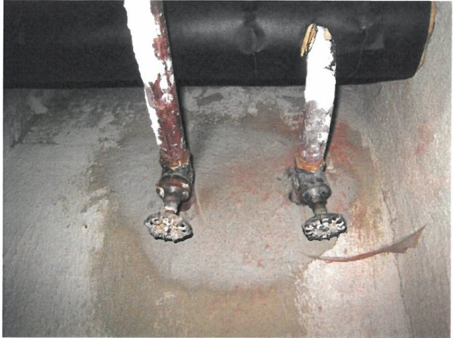
Kuva 11. Esim. Majarin kellarikerroksen putkikanaalin katon rajasta ylöspäin lähtevissä lämmitysverkoston runkohaaroissa on vielä käytössä alkupe räisiä karamallisia sulkuventtiilejä. Paluupuolen vanhoihin linjasulkuventtiileihin ei liity linjahaarakohtaisten vesivirtaamien säätö- tai mittaussmahdollisuutta.
