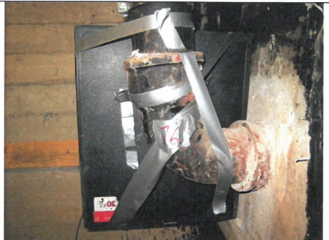
Kuva 16. RTG16, Pystyviemärilinjan putkiosat 112/6,0 mm.
