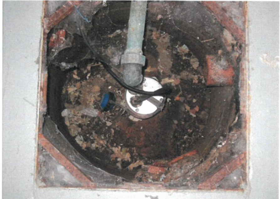
Kuva 10. Majarin kellarikerroksen käytävätilan lattiarakenteen alapuolella on noin 800 mm:n syvyinen salaojaverkoston pumppukaivo. Katselmushetkellä pumppukaivon pohja oli kuivana. Kaivon kellukeohjattu uppopumppulaitteisto havaittiin koekäytössä toimivaksi. Kaivolle tulevat salaojalinjat ovat putkitettuina tiilisalaojaputkituksilla.
