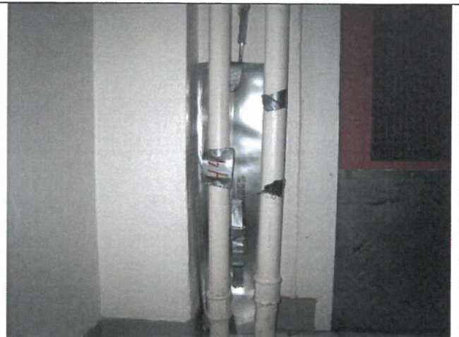
Kuva 44. RTG44, Lj-runkohaara, menoputki 33,7/3,25 mm.
