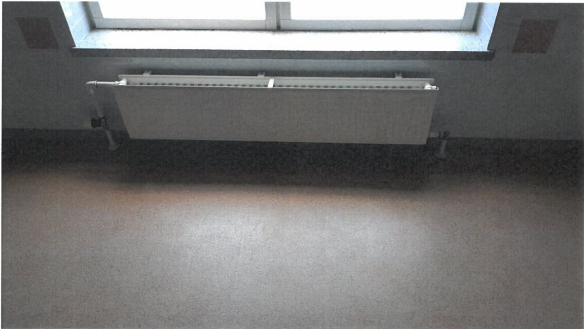
Kuva 8. Liikuntasalipäädyn märkätilassa lattian lävistäviä lämpöjohtoja
