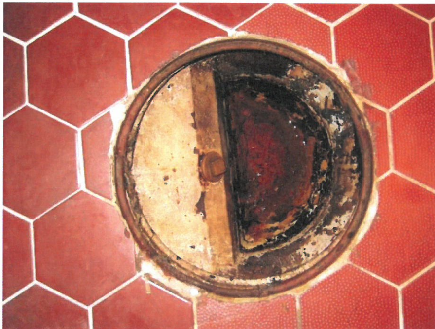
Kuva 8. Majarin kellarikerroksen saunaosaston pesuhuonetilassa lattiakäivossa on valurautainen kaivokulho ja matala kuparinen korokerengas. Valurautakulhon emalipinnalla erottuu vasta vähäiseksi luokiteltavia pintaruostejälkiä.
