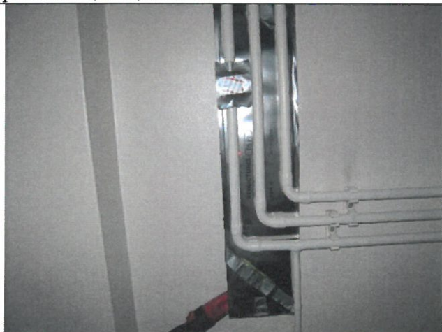
Kuva 41. RTG41, Kv-, lv- ja lvk-kytkentähaarat 15/1,0 mm (uusittua kupariputkea!)
