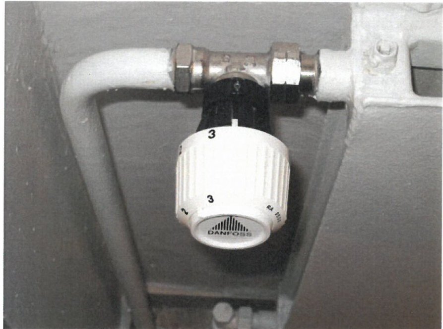
Kuva 13. Kohderakennuksen lämmityspattereissa säätölaitteena toimivat uusitut ja toimivalla esisäätöpohjalla varustetut Danfossin termostaattiventtiilit. Lämmityspattereiden kytkentähaarat nousevat pattereille yleensä lattiarakenteen sisältä.
