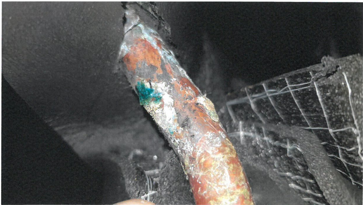
Kuva 20. Korroosiota 1. kerroksen alakatossa olevassa lämpimän käyttöveden johdossa
