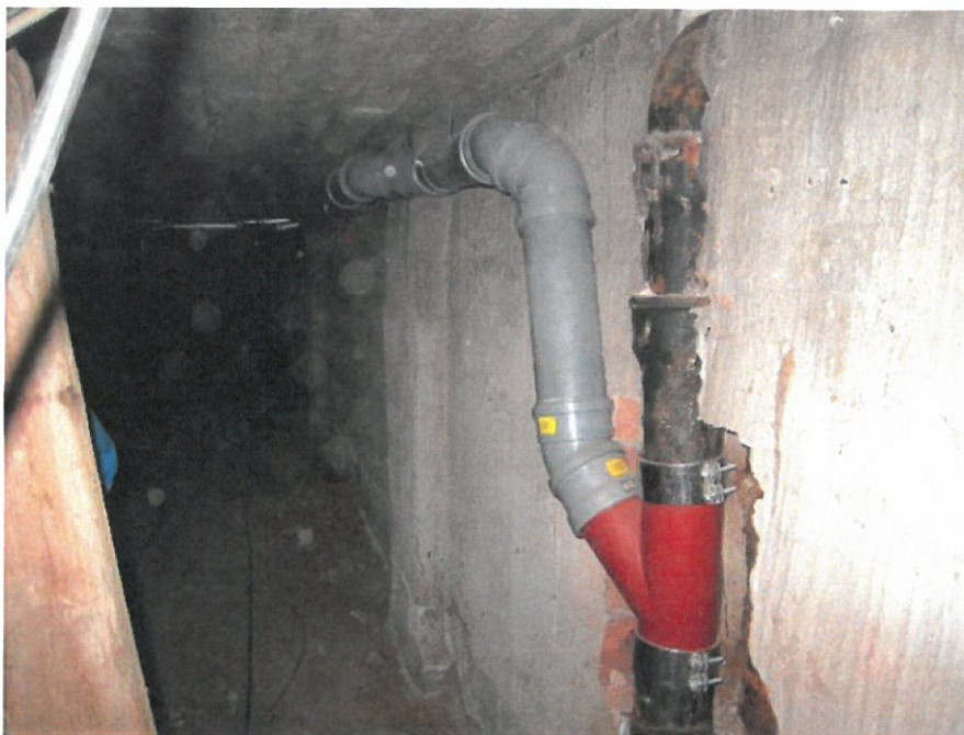
Kuva 7. Koulurakennuksen kellarikerroksen putkikanaalien seinustoilla kulkeviin ja valurautaviemärin putkiosilla putkitettuihin pystyviemärilinjoihin on liitetty paikallisilla täydennys- ja/tai korjausasennuskohdilla myös muoviviemärin putkiosilla putkitettuja uusia viemärilinoja.
