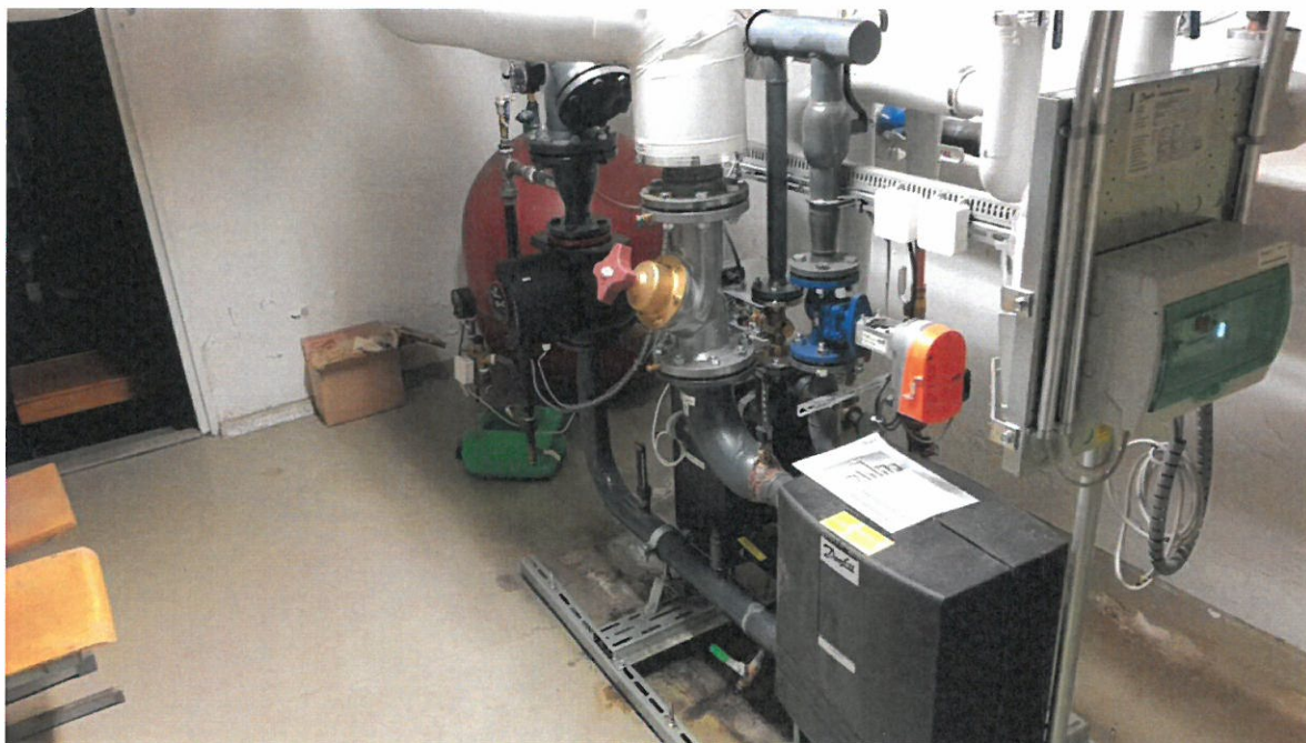
Kuva 1. Kaukolämmön alajakokeskus lämmönjakuhuoneessa
