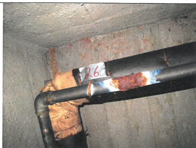
Kuva 26. RTG26, Kv-runkolinja 48,25/3,5 mm.
