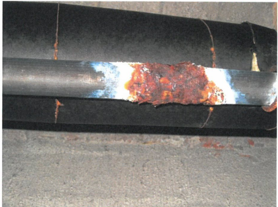
Kuva 2. Majarin kellarikerroksen putkikanaalin katon rajassa kulkevassa \varnothing 33,5 mm:n sinkityllä teräsputkella putkitetussa kv-runkohaarassa erottui katselmushetkellä useitakin tihkuvuotokohtia. Kyseisen kv-runkohaaran yhtä paikallista tihkuvuotokohtaa tutkittiin röntgenkuvaamalla putkiosuutta tunnuksella RTG23.
