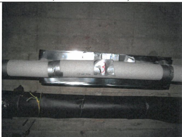
Kuva 3. RTG3, Kv-runkohaara 35/1,5 mm (uusittua kupariputkea!).
