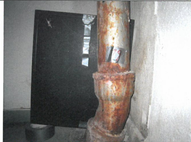
Kuva 19. RTG19, Pystyviemärilinjan putkiosat lähellä lattian rajaa 112/6,0 mm.
